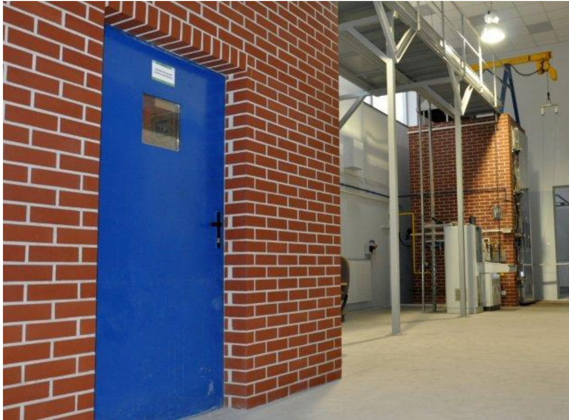
Požární zkušební laboratoř v Tele-Fonika, Krakow Základní pohled na zkušební komoru podle EN 50339
